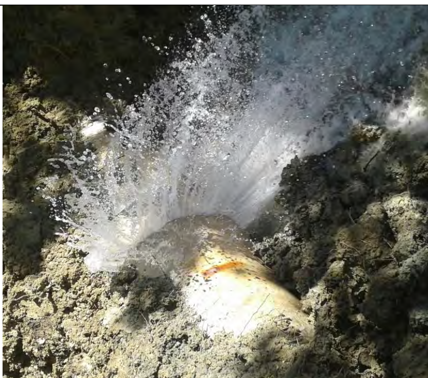
Sisma 2016: Rottura condotta Acquedotto Pescara
